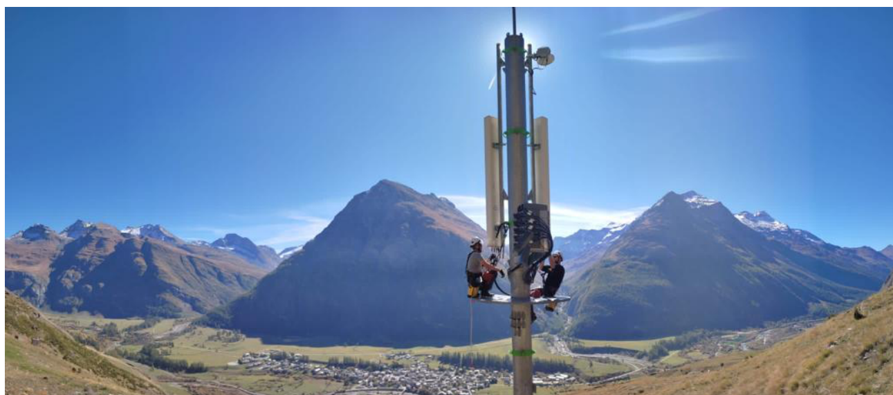
Intervention des équipes Free Mobile sur un pylône à Bessans (73) le 6 octobre dernier
